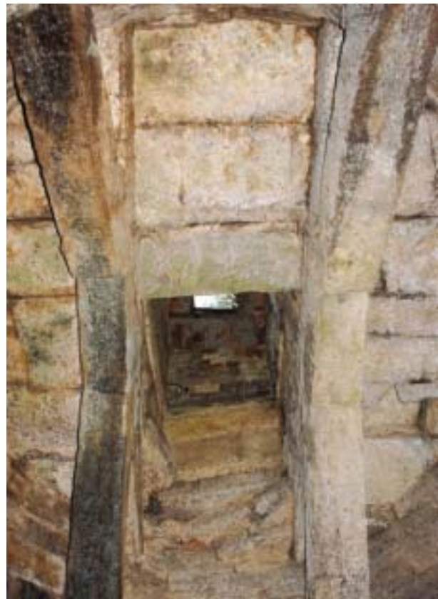
Pozzo Sorbello - Particolare del sistema di copertura a capriate con poderosi monoliti in travertino. La chiusura della canna è costituita da lastroni della stessa pietra poggiati sulle travature e sul perimetro del paramento.
